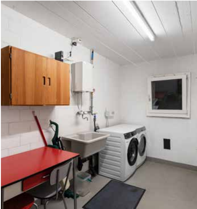
Wasch-/Trocknungsraum: Waschvollautomat und Tumbler im eigenen Wasch-/Trocknungsraum im Untergeschoss.
