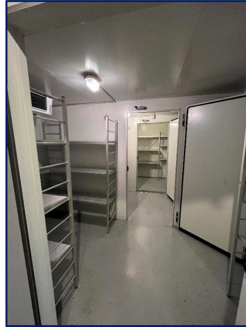
Kühl- und Tiefkühlzelle 3-teilig
