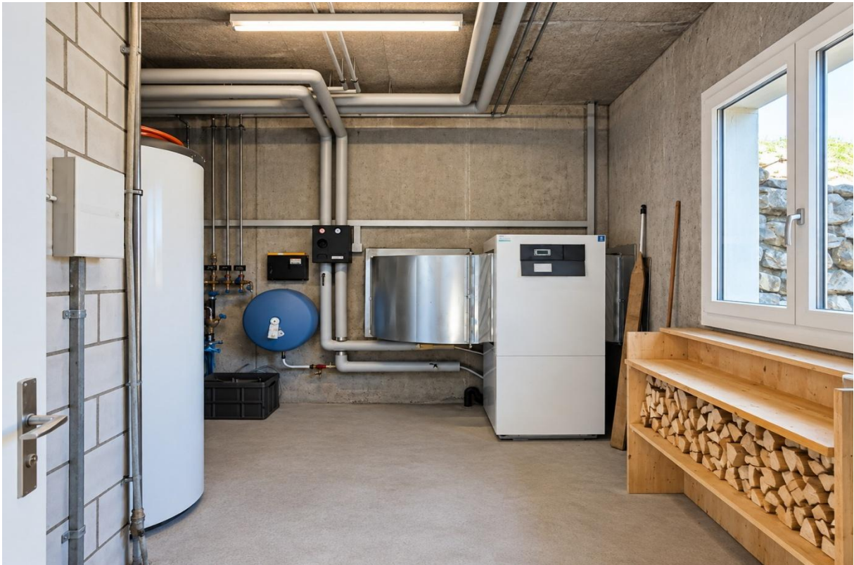
Der Technikraum im Untergeschoss bietet zusätzlich Platz zur Lagerung von Brennholz.
