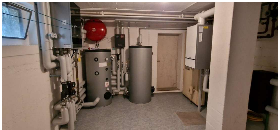
Haustechnik UG (Weitwinkel Foto)
