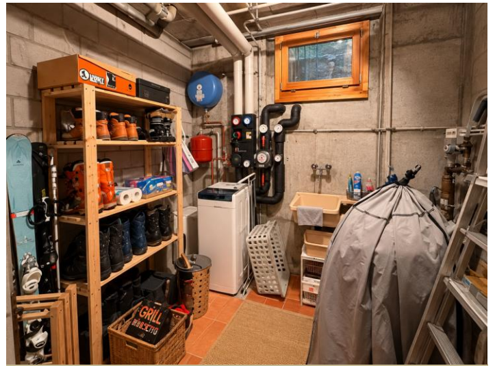
Heizungs- / Technik- / Abstellraum
