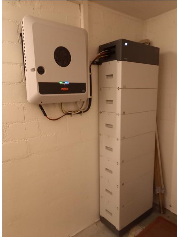
Wechselrichter und Batteriespeicher
