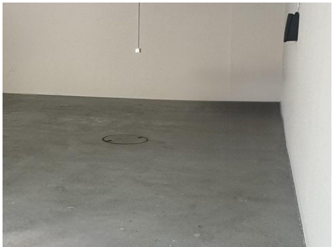
Einstellhallenplatz mit Ladevorrichtung
