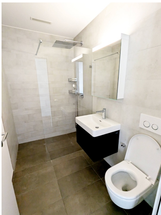
Nasszelle mit bodenebener Rain-Dusche
