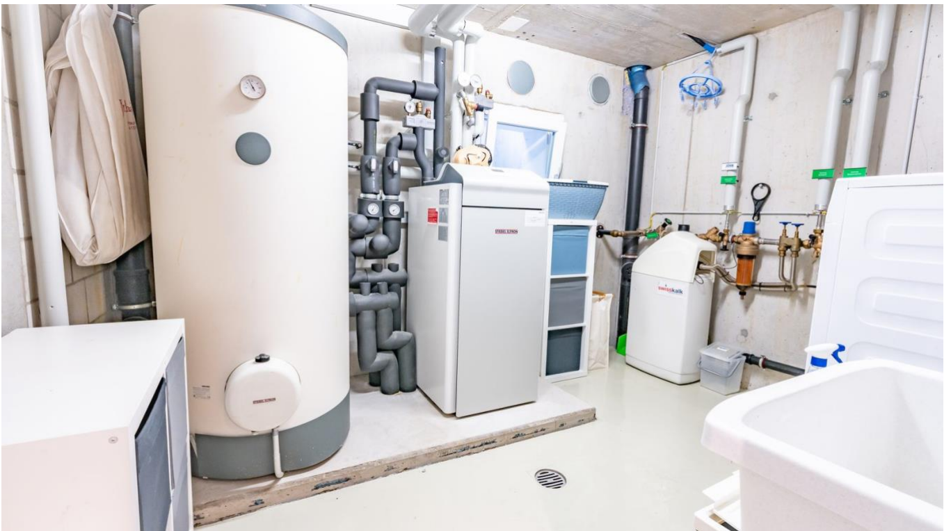
Technik- & Waschküche – Wärmepumpe & Wasserenthärtungsanlage
