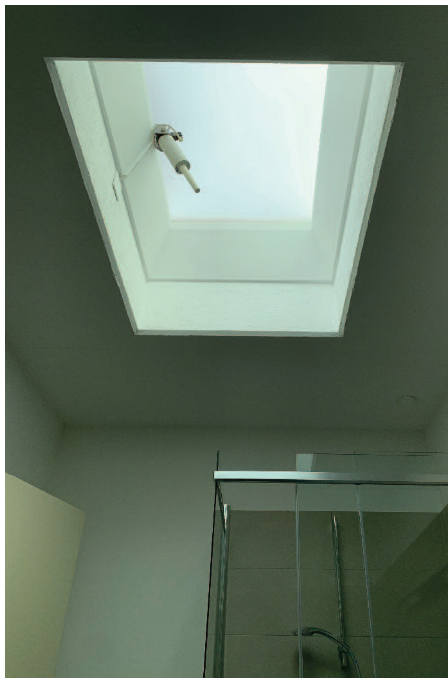
Bagno con lucernario ad apertura elettrica per luce e ricambio d'aria.
