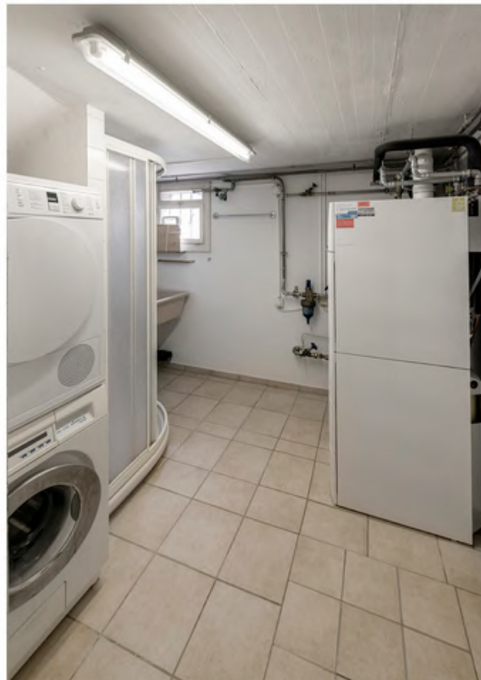
Keller: Waschküche-Heizung, mit Dusche
