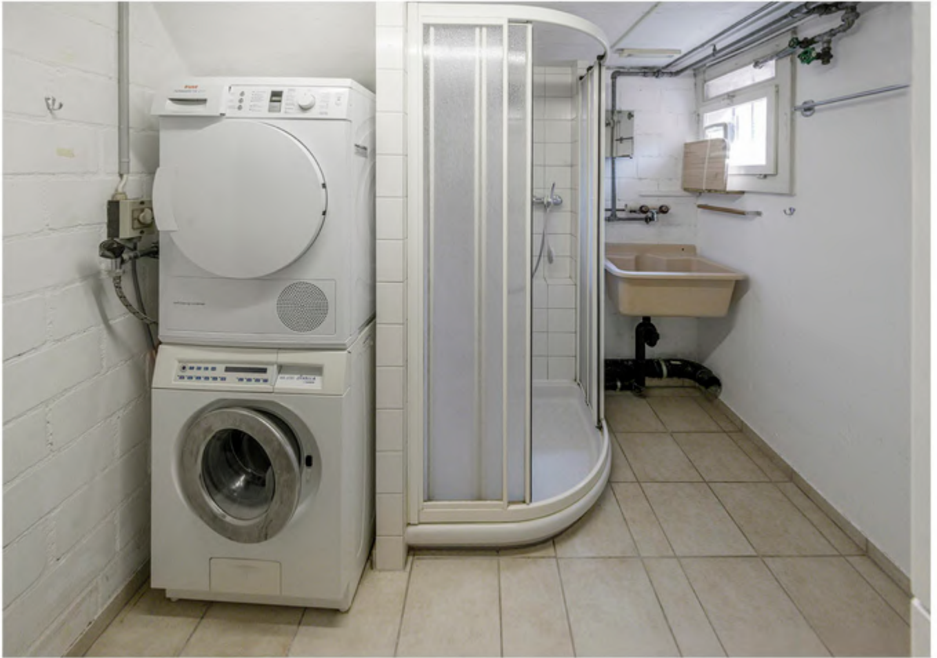
Keller: Waschküche-Heizung, mit Dusche
