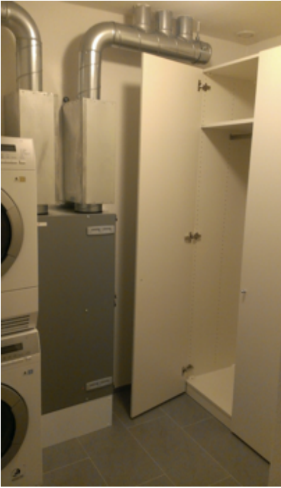
Reduit mit Schrank / Waschturm / Komfortlüftung
