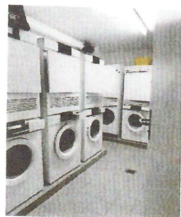
Waschraum mit eigenen Maschinen
