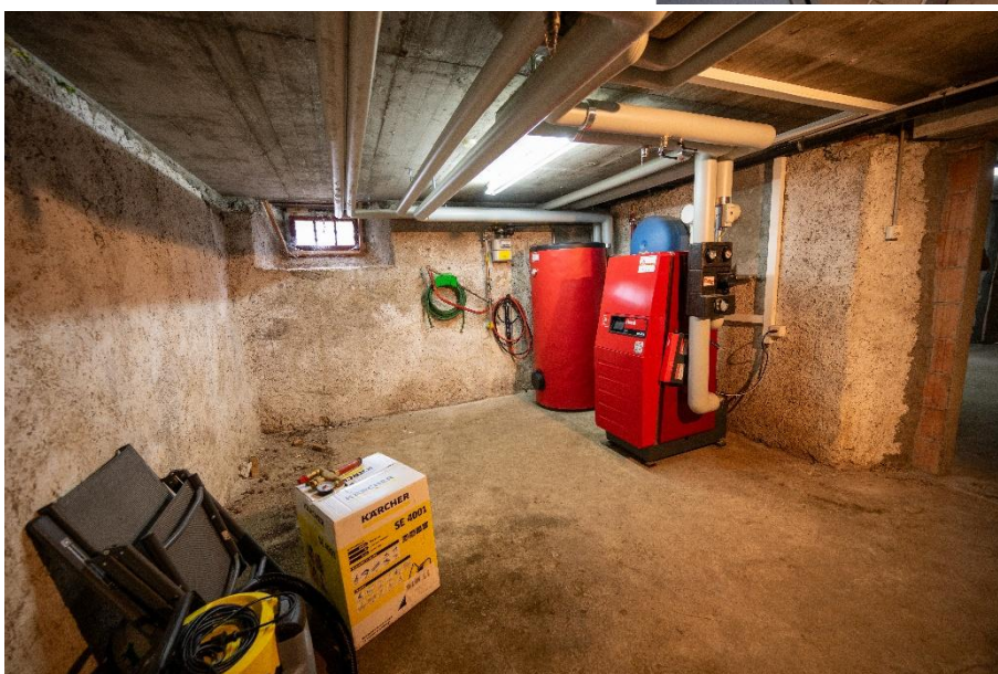
Heizung im Keller
