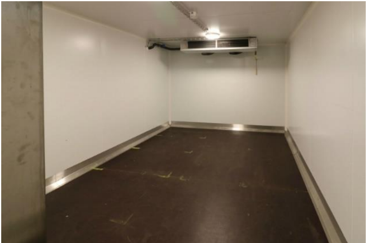
Kühlraum Schopfanbau, Obergeschoss
