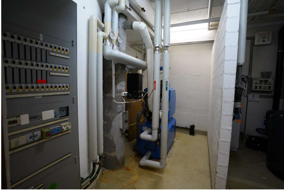
Abbildung 33 - Heizung und Pool
