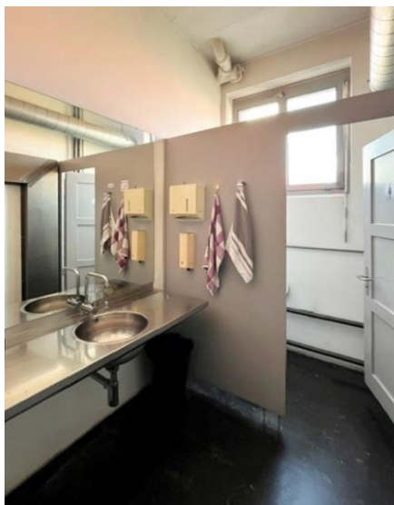
Toilettenanlage mit einem WC
