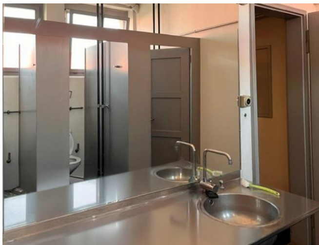
Toilettenanlage mit zwei WCs und einem Pissoir
