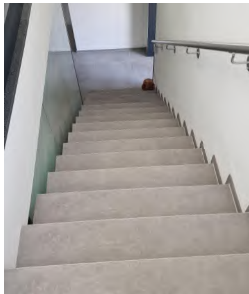
Wohnungstreppe II OG – Attika
