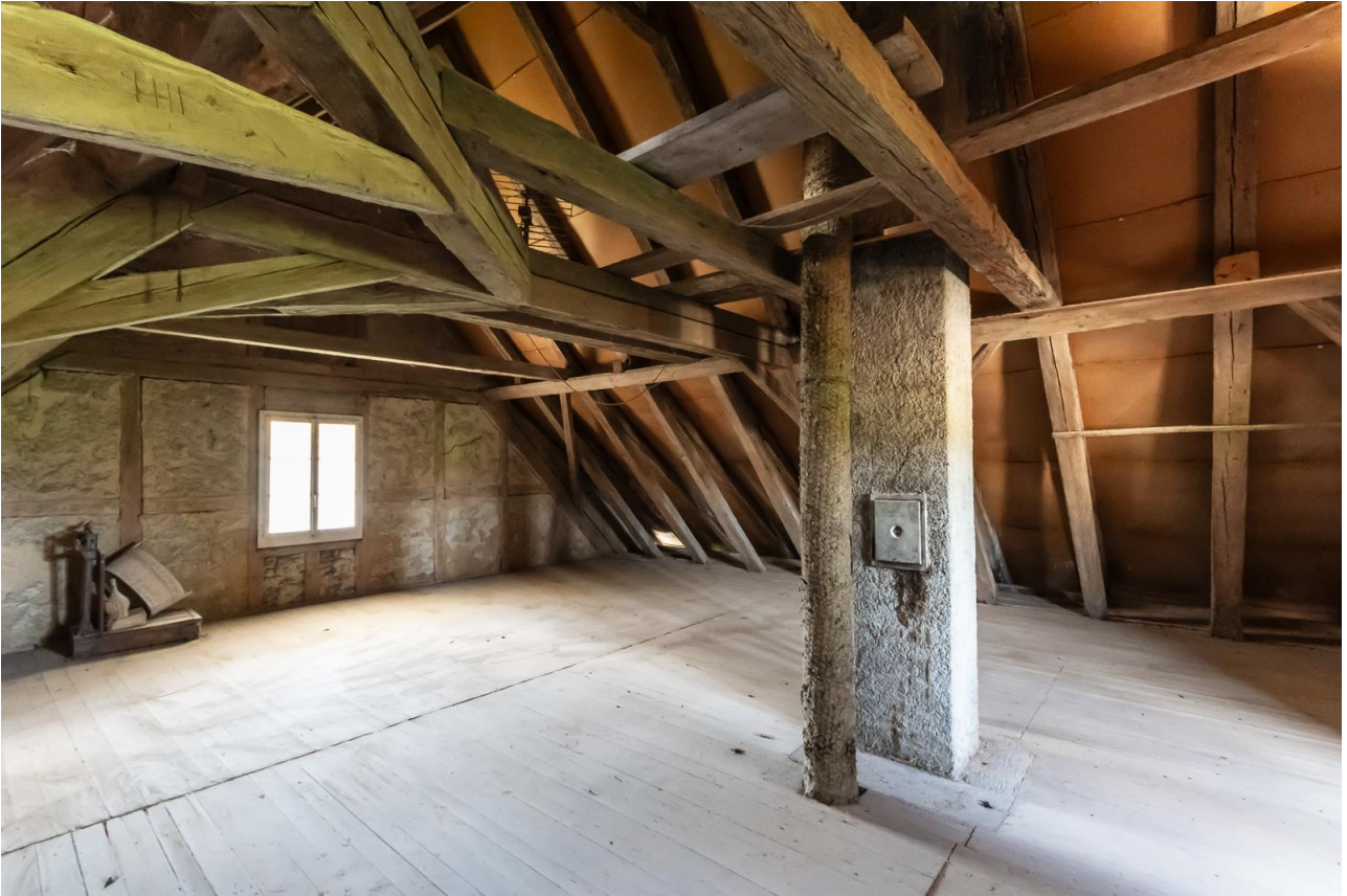
Estrich DG, nicht ausgebaut
