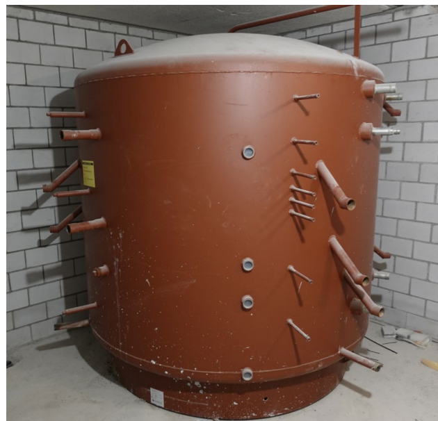
Energietank im Untergeschoss
