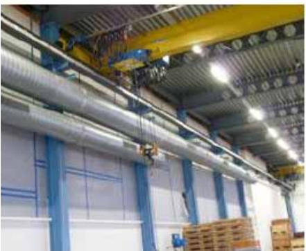
Hallenkran und Lüftungssystem
