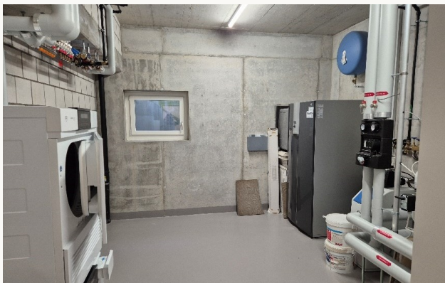
Technikraum mit Wärmepumpe, Pufferspeicher und Waschbereich
