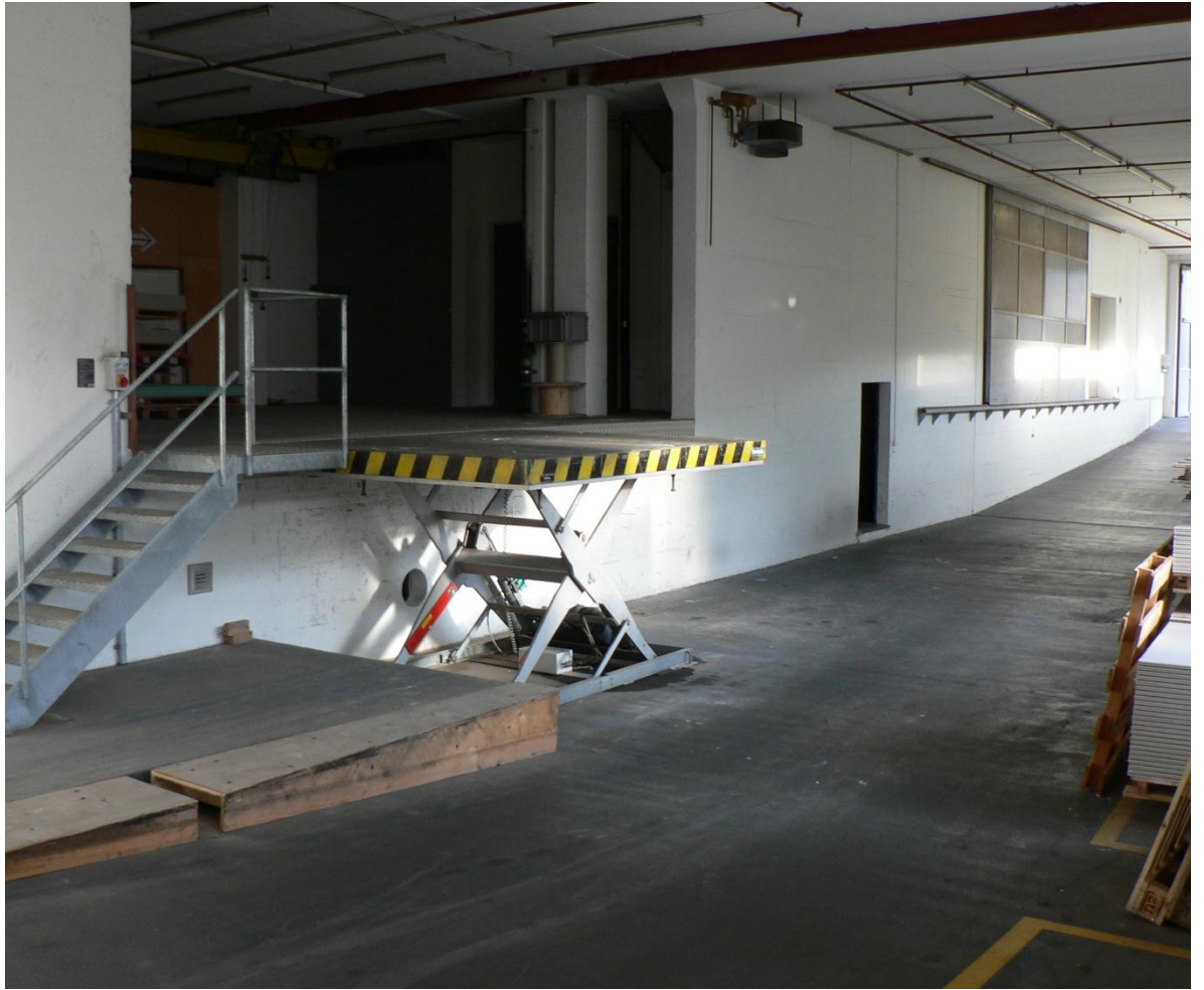
Anlieferung mit Hebebühne und Warenlift
