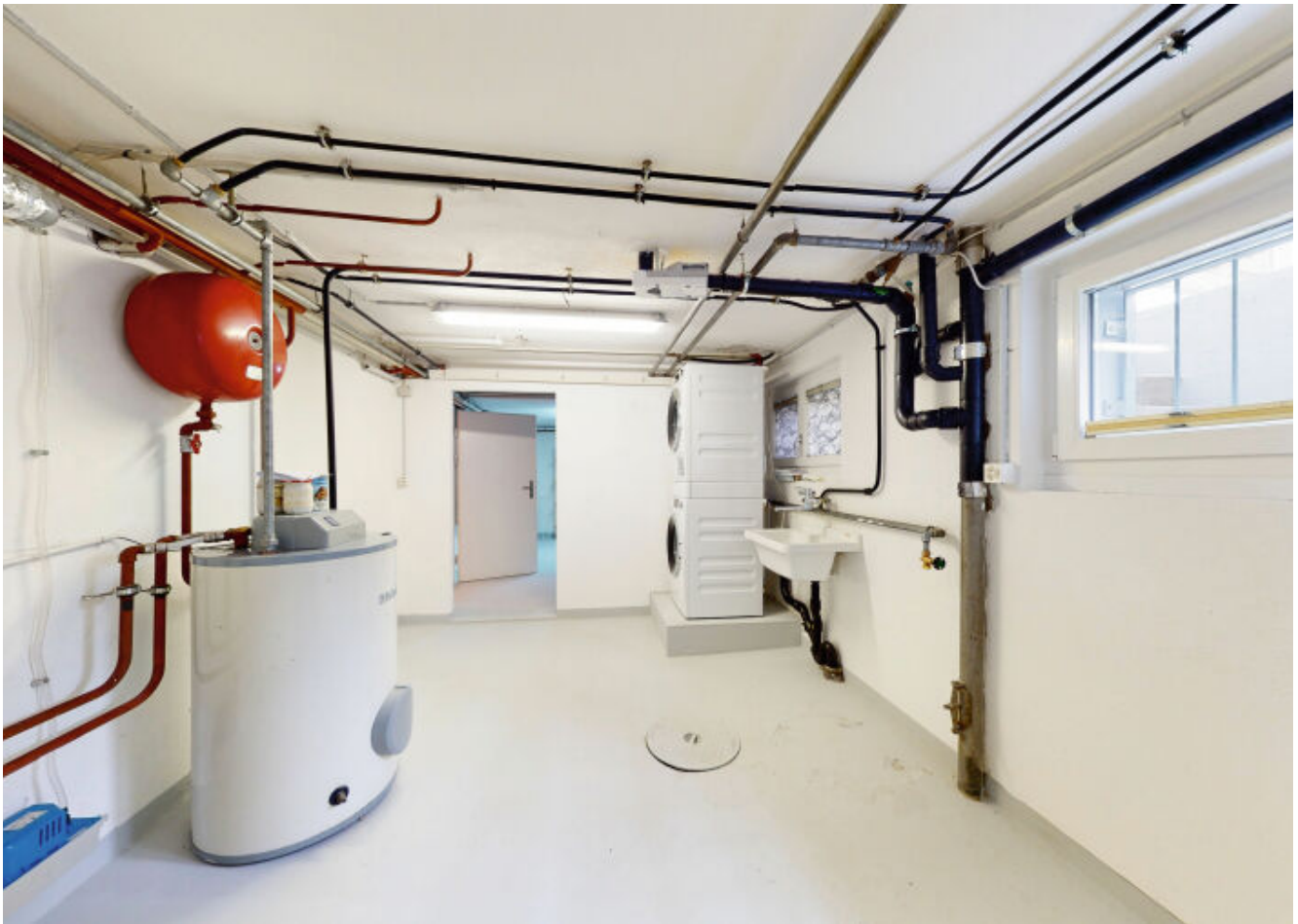
Waschküche und Heizungsraum.
