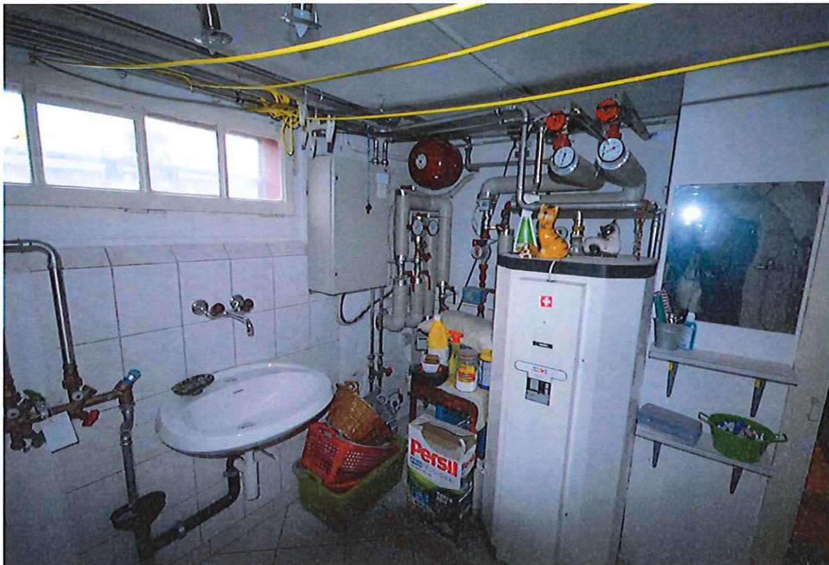
Local technique, buanderie au sous-sol
