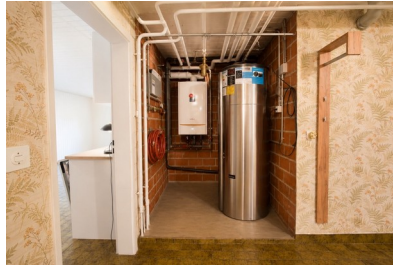
Heizzentrale und Wärmepumpenboiler 2023
