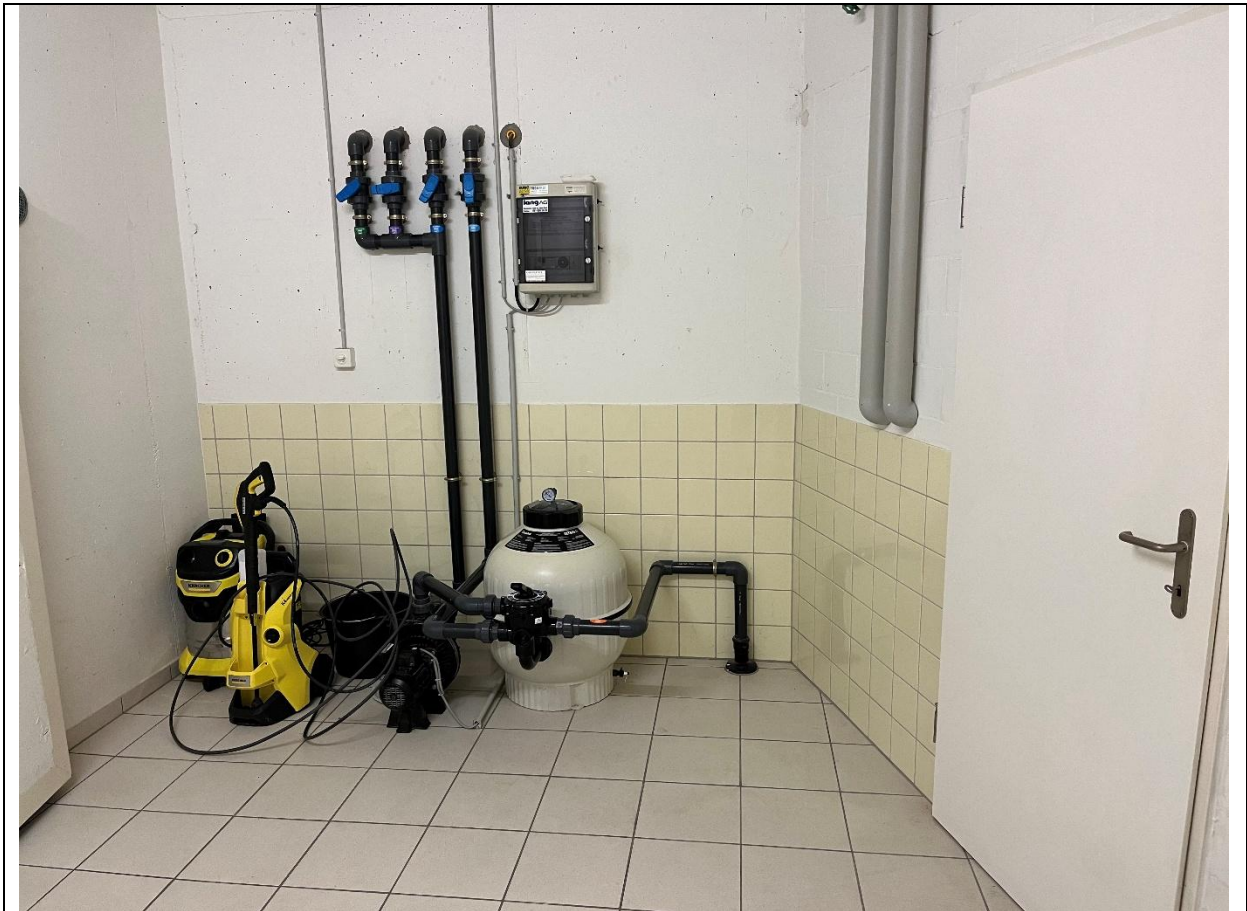
Vorraum zur Garage mit Pooltechnik, links Eingang zum Luftschutzkeller, rechts Ausgang zur Doppelgarage.
