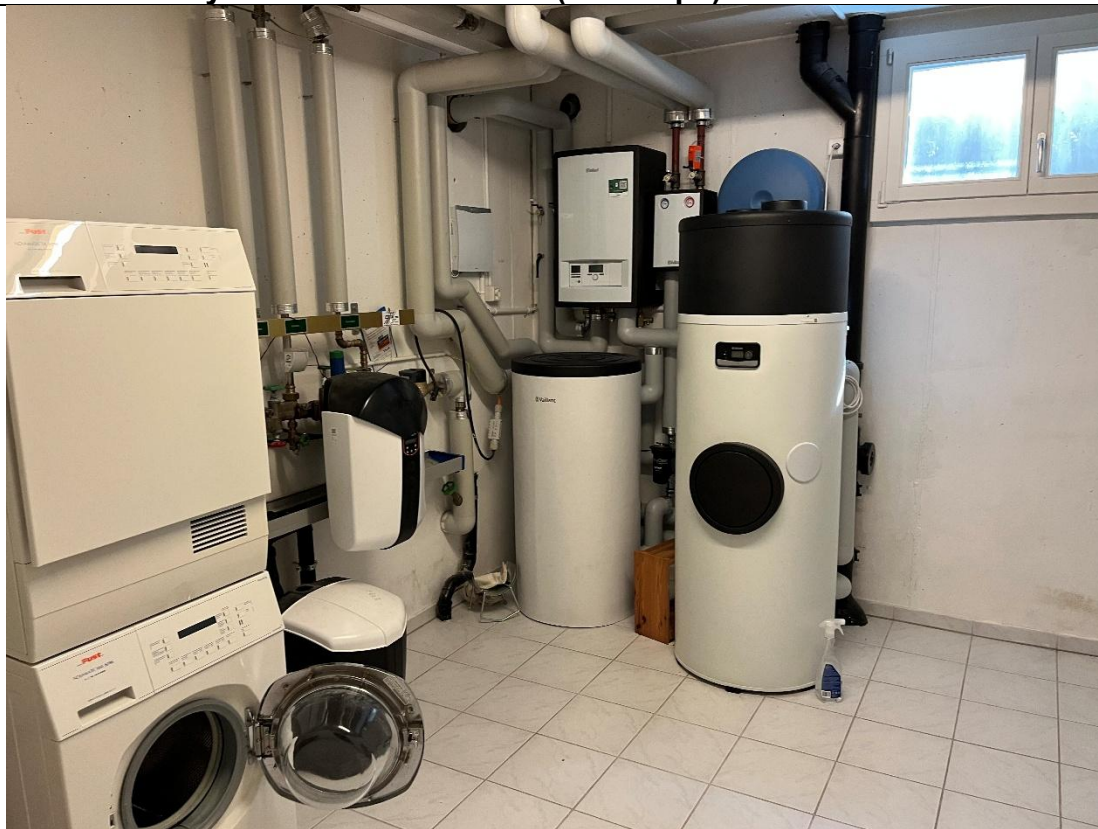
Technikraum mit Wärmepumpe, Waschmaschine, etc (ca 17 qm)
