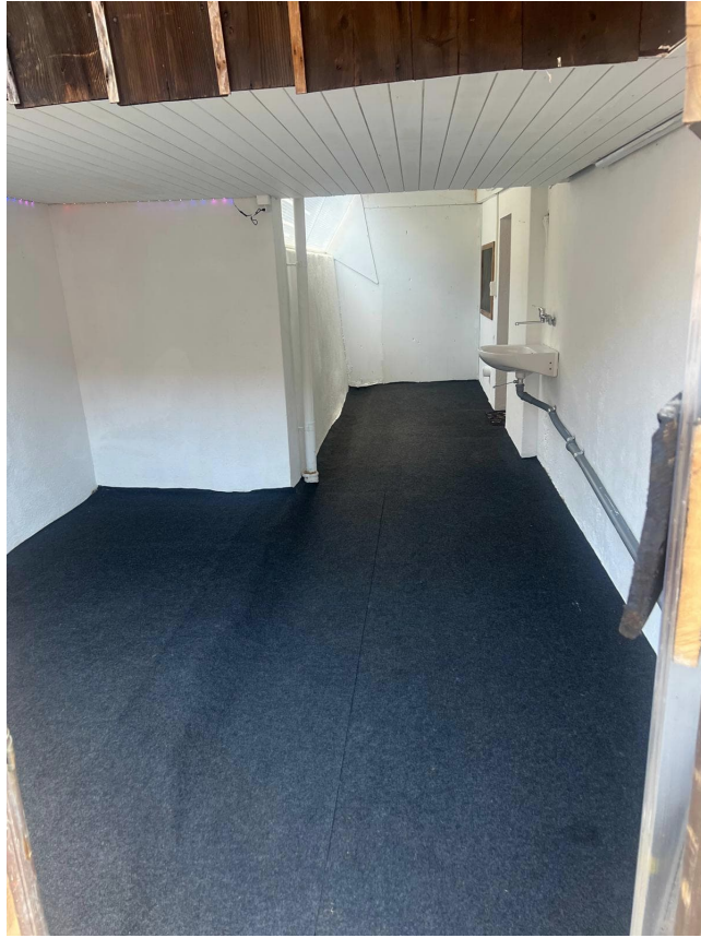
Provisorischer Wintergarten mit Wasserzufuhr und Abfluss (2025)
