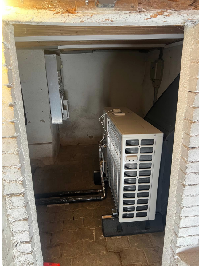
Keller und Technikraum – Neue Wärmepumpenheizung (Ende 2024)
